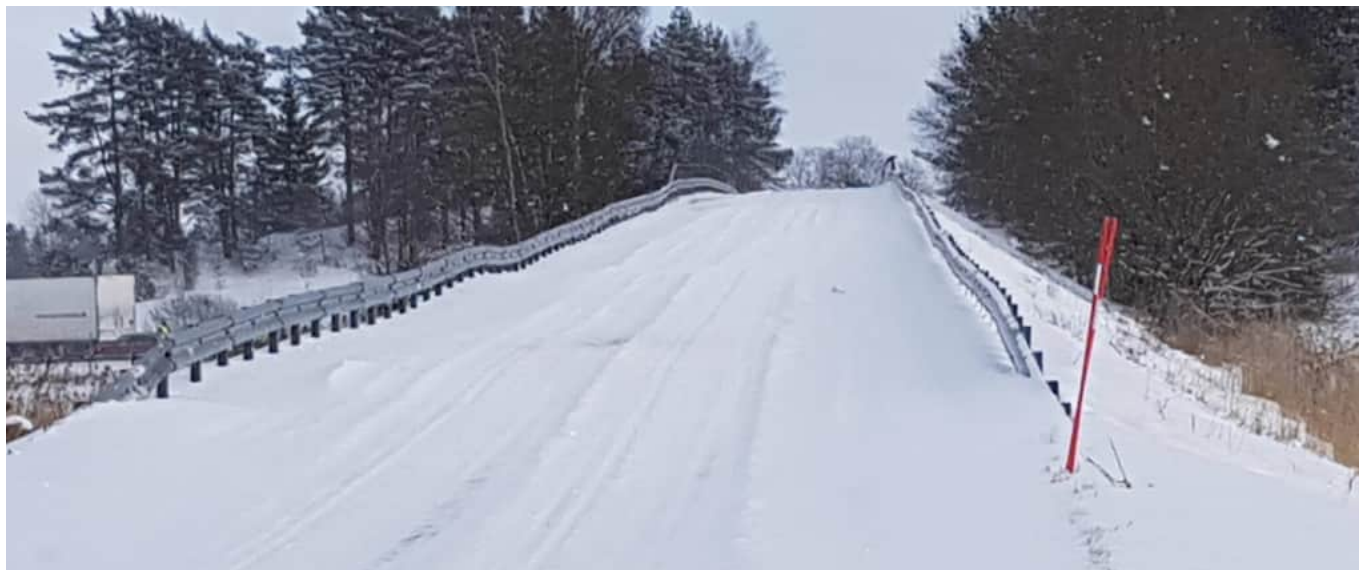
Figur 7.38. Fältinventering, synbara sättningar. Vägen har justerats.
