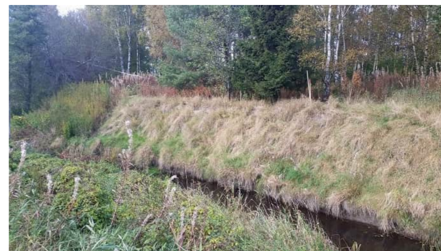
Figur 7.3.3.3. Moraån. Åkanterna har spår av skred.
