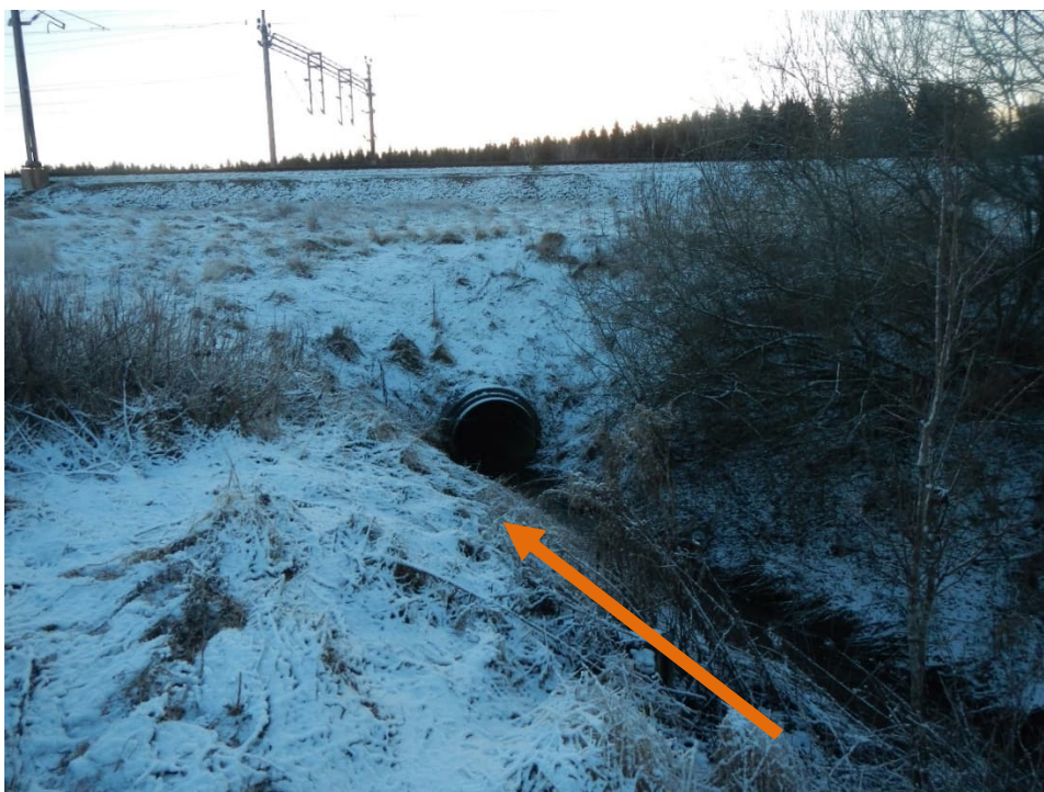
Figur 3 Bild på dike Gerstabergr uppströms befintlig järnväg, trumma igenom befintlig järnvägsanläggning. Orange pil symboliserar strömningsriktningen.
