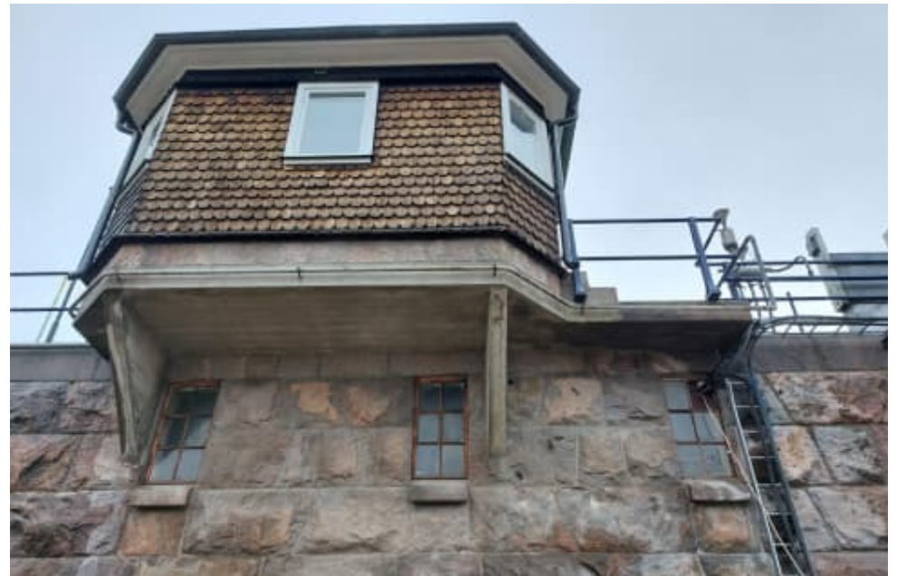
Figur 72. 1916 års manöverhytt flyttades ut över kajkanten under mitten av 1900-talet, troligen för att skapa mer yta. Fönstren i muren anknyter till ställverkets fönster.
