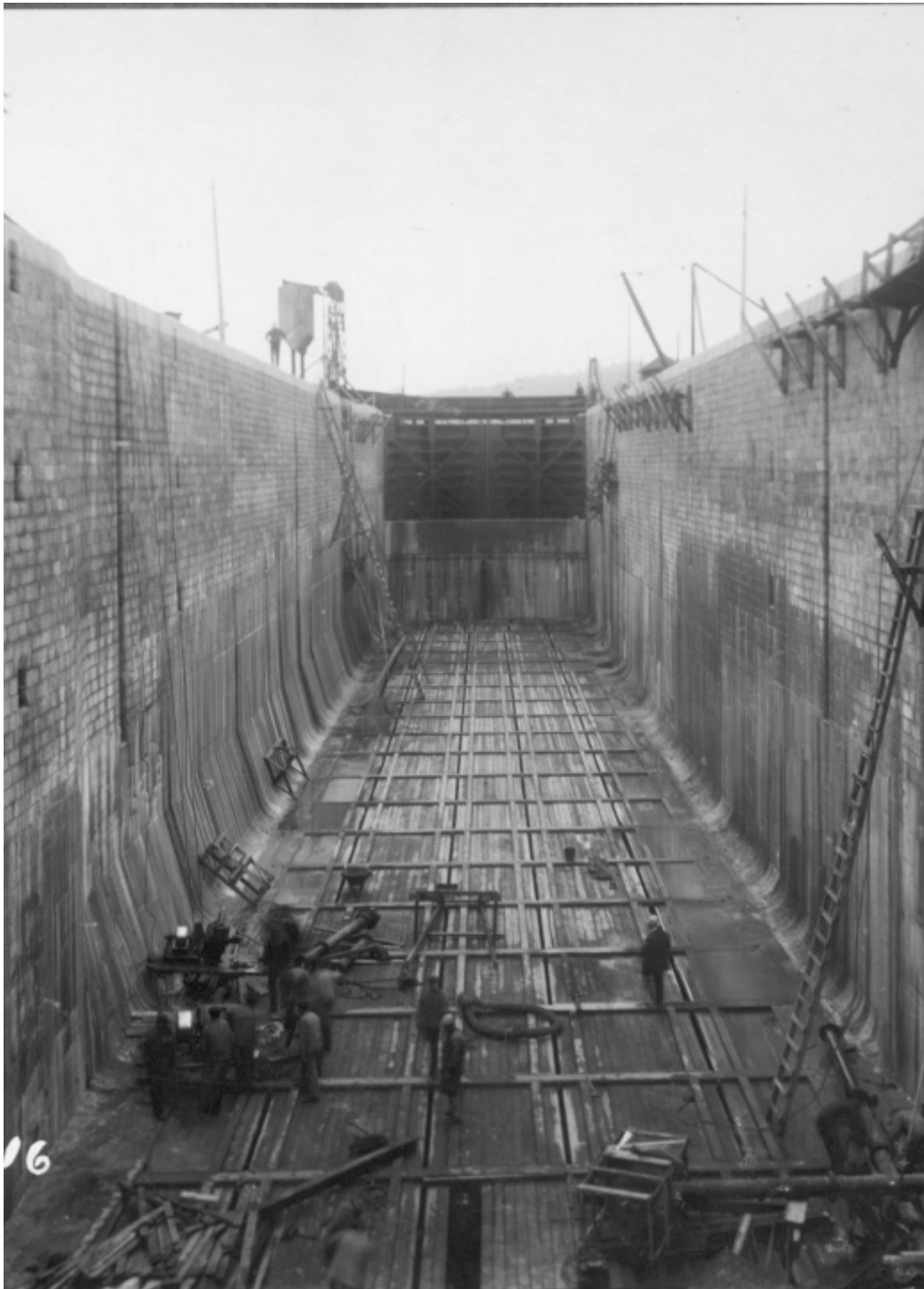
Figur 85. 31 augusti 1916. Slussen är i princip färdigbyggd och de mäktiga slussportarna har satts på plats. Sjöfartsverket.
