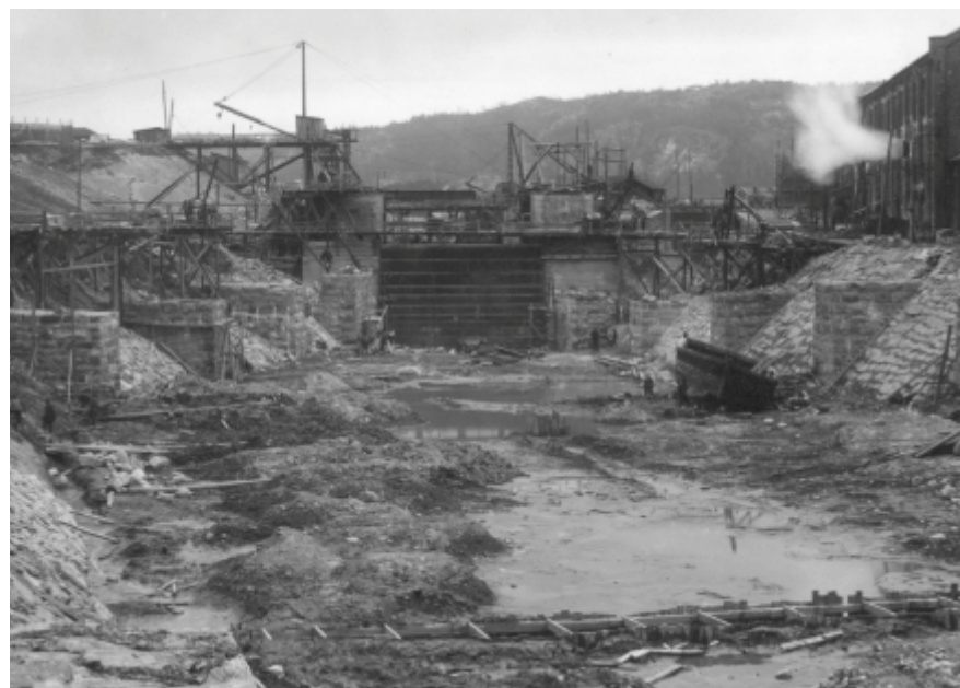
Figur 82. Bild tagen från höljan söder om slussen våren 1916. Det nedre portparet börjar ta form. Sjöfartsverket.
