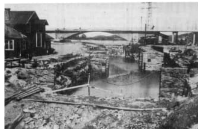
Figur 20. Restaureringsarbete av 1607/1784 års sluss i samband med kraftverksbygget, 1928. Den nybyggda Göta Älvbron syns i bakgrunden. lillaedetbilder.se .
