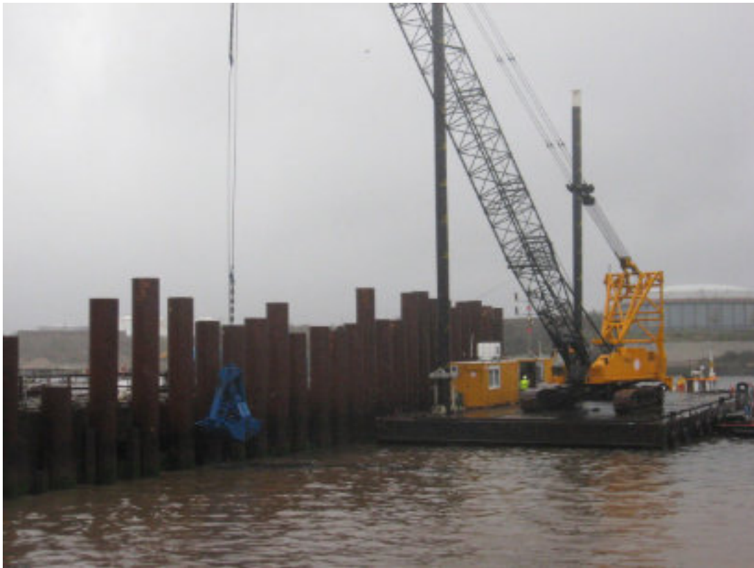
Figur 79. Muddring med enskopeverk från ponton. I detta fall utrustad med en gripskopa.
