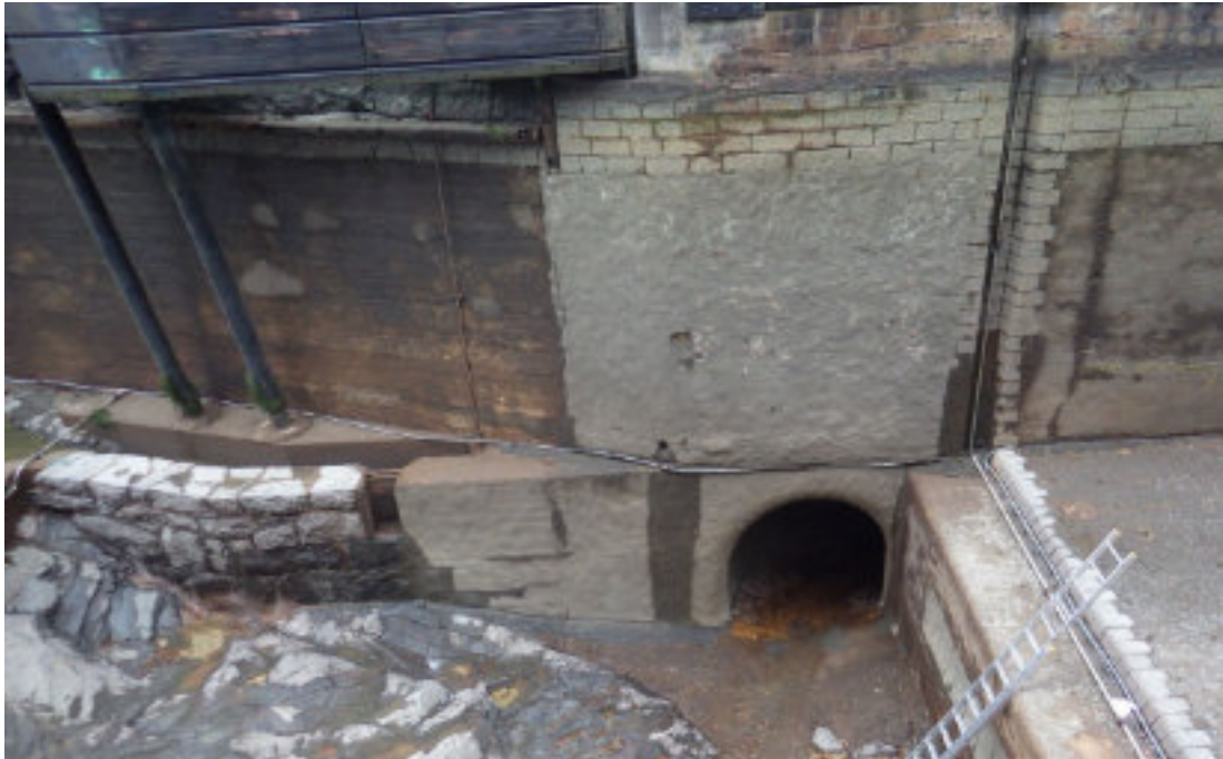
Figur 23. Tilloppskanal uppströms sluss. Slusshuvudet till höger i bild. Tömd sluss, exempel från en av slussarna i Trollhättan.
