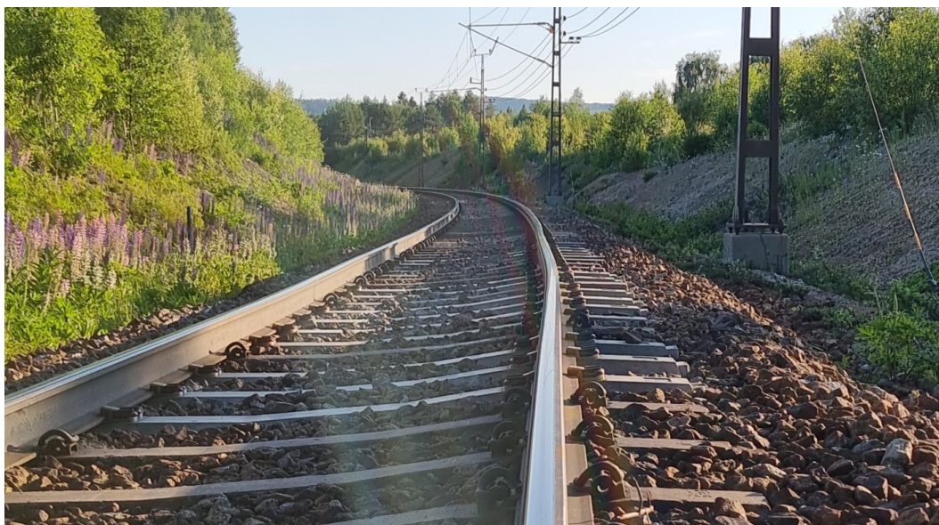
Bild 2 Solkurva på sträckan Mellansel-Gottne, bandel 129, sommaren 2025. En bakomliggande orsak till händelsen var låg spänningsfri temperatur (SFT).
