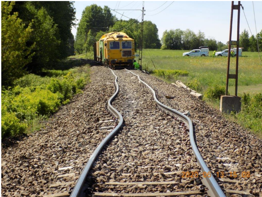
Bild 2; Arbetsfordon som spårat ur till följd av misstänkt solkurva, Torpshammar, sommaren 2020. Spår i cirkulärkurva med betongslipers och Pandrol e-clip befästning.
