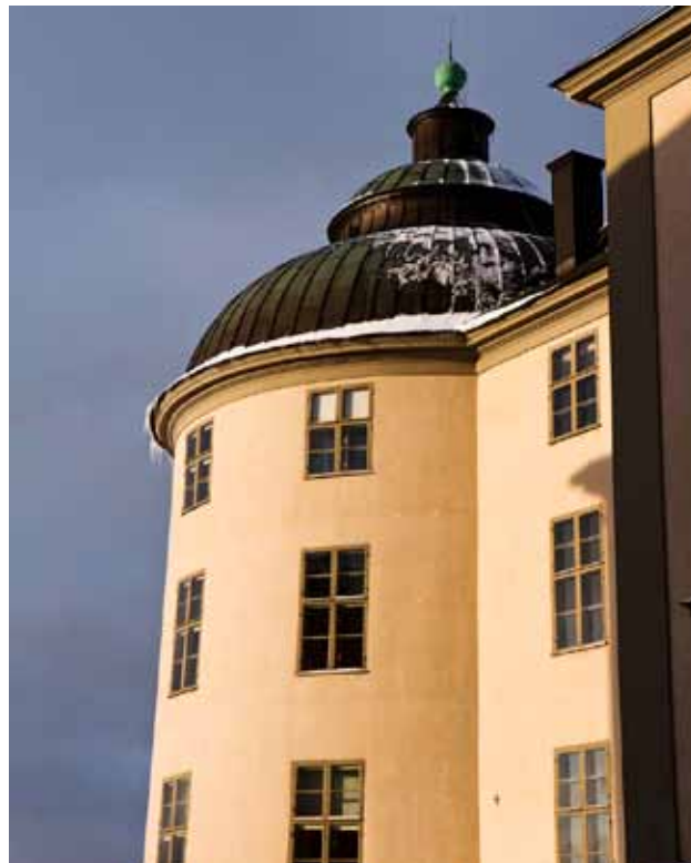
Ovan: I Wrangelska palatset finns 58 kontrollpunkter. Nedan: En "gipsvakt" läggs i sprickan. Om det sedan blir en spricka mellan gipset och den ena sidan, så indikerar det att sprickan vidgat sig.
