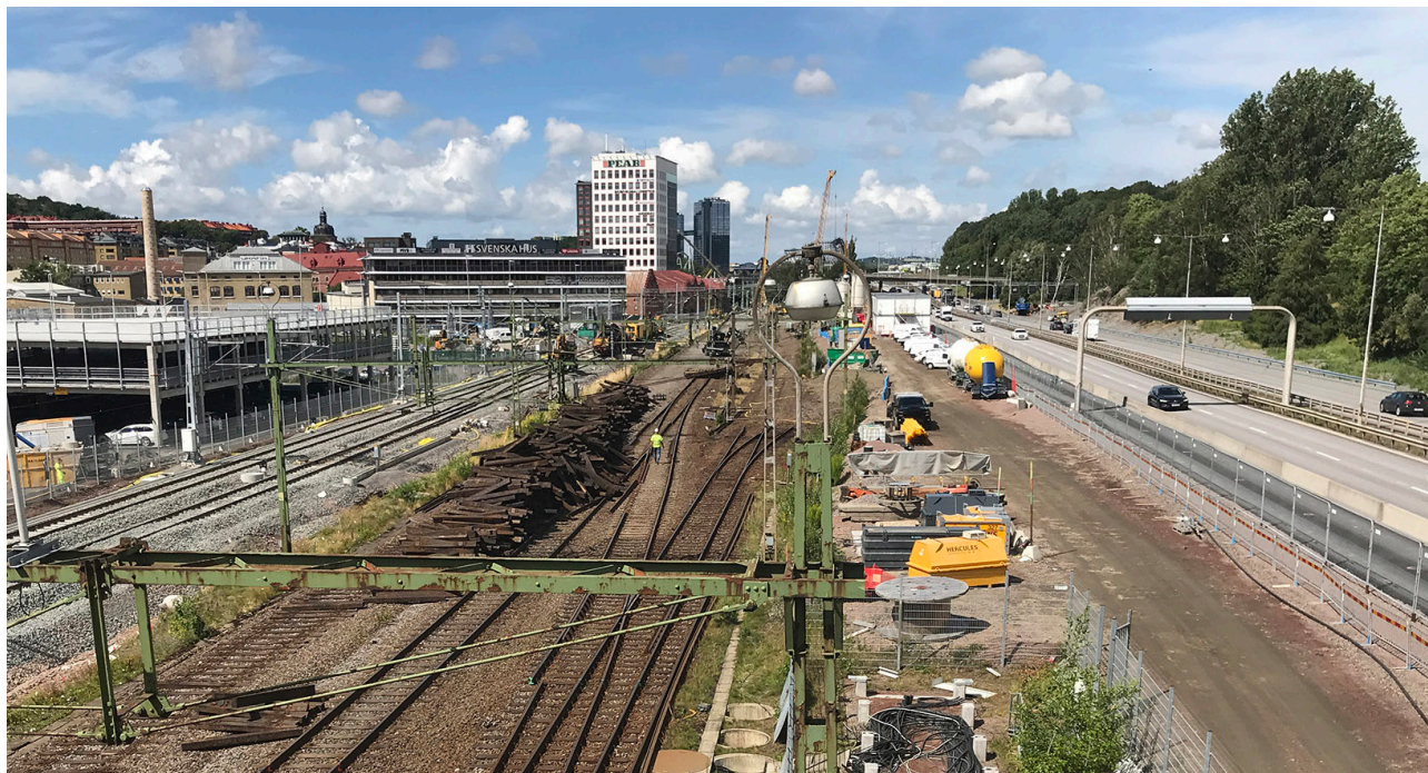
Spårområdet i Almedal sett från söder. De gamla spåren på Västkustbanan rivs upp för att göra plats för Västlänken som ska passera platsen under jord i en betongtunnel. Tågtrafiken leds under byggtiden om på de tillfälliga spåren till vänster i bild.
