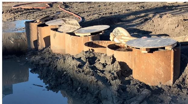
Stålplåtarna sätts ner tätt intill varandra så att de bildar en vägg för schaktet.
