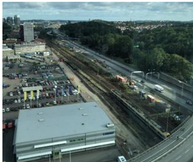
Vy från Sankt Sigfridsbron ut mot Almedalsvägen där de tillfälliga spåren byggs jämte befintlig järnväg. Vi arbetar även mellan järnvägen och E6.
