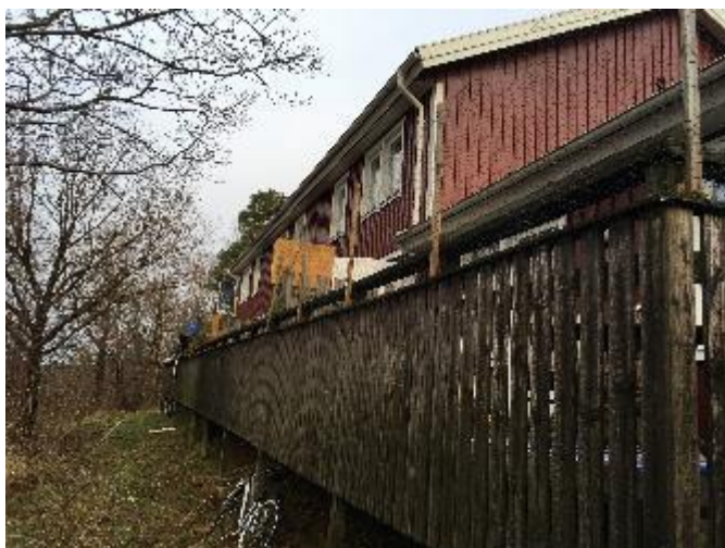
Fasad mot väster (långsida) samt gavel (söder). Uteplats framför huset, dvs åt väster.
