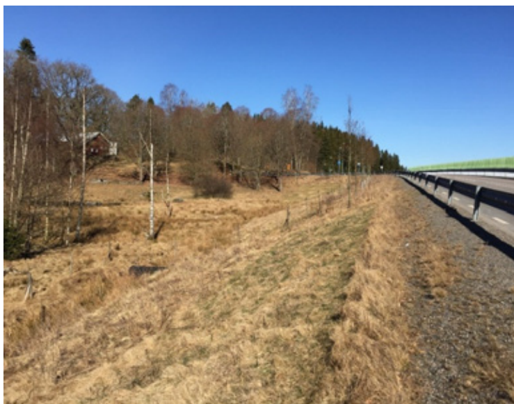
Figur 25: Från söder, del av sträcka där gång- och cykelvägen utformas med stödmur samt räcke för att minimera markanspråket vid det generellt biotopskyddade området.
