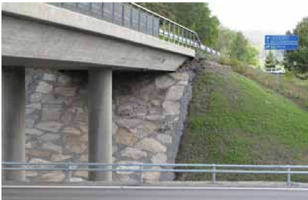
Exempel på broformning med runda pelare, sluttande kantbalk, gräsbesådda brokoner och stensättning under bronns droppkant.
