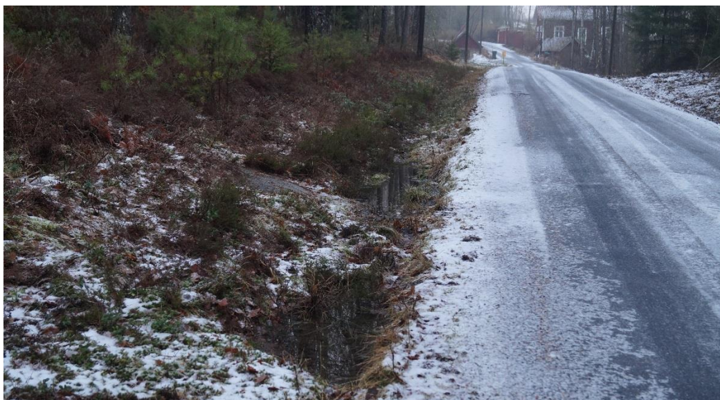
Bild 3. Exempel på dåligt fungerande vägdiken.
