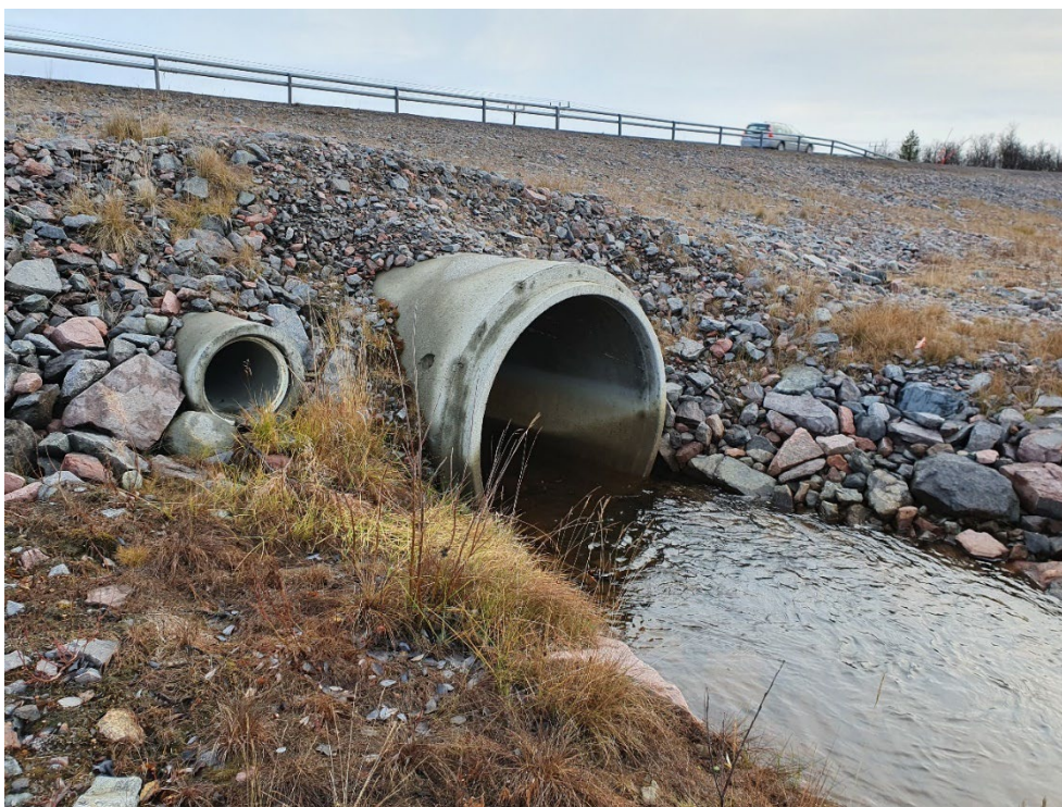
Figur 16. Befintlig torrtrumma för medelstora däggdjur och vattenfaunapassage vid biflöde till Luossajoki.
