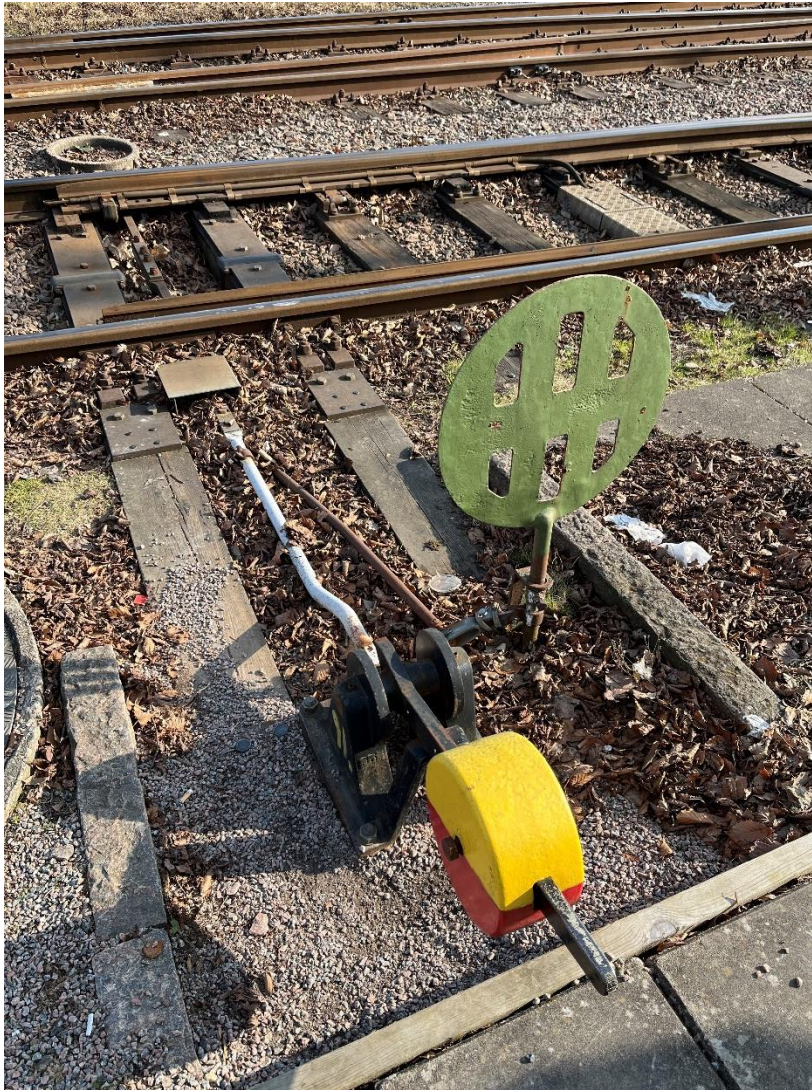
Figur B34. En av stationens mellan 15 och 20 klotväxlar och klotreglerade spårspärrar.
