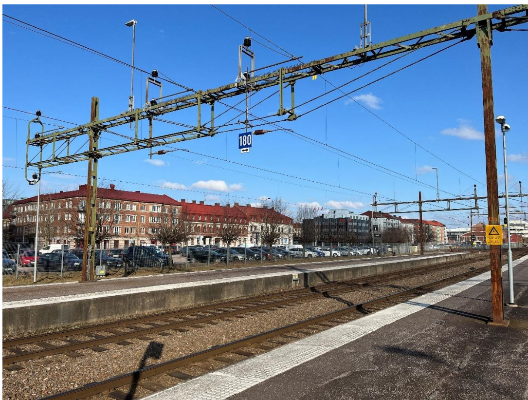
Figur B35. Exempel på stationens kontaktledningsinstallationer. Grönmalad brygga som sannolikt är ursprunglig sedan 1935 när stationen elektrifierades. Enstaka delar som utliggare och armaturer är nyare. Stationen har tidigare haft de klassiska lyabyglarna för bangårdsbelysning.
