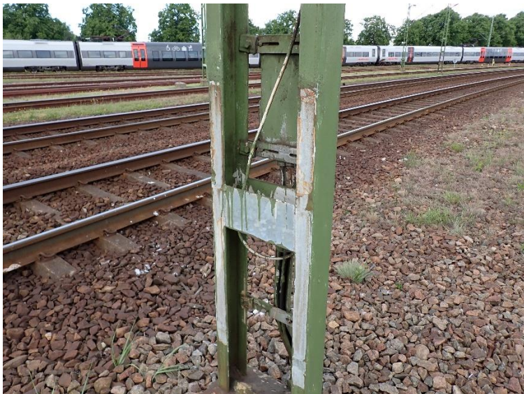
Figur 14. Kontaktledningsstolpe med färg som kan innehålla förhöjda halter av PCB och bly.
