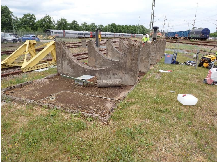
Figur 11. Cisternfundament i betong som kan innehålla förhöjda halter av PCB, metaller (krom och krom 6), PAH och oljeföreningar.
