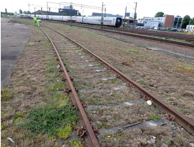
Figur 12. Betongslipers som kan innehålla förhöjda halter av metaller (krom och krom 6), PAH och oljeföreningar.
