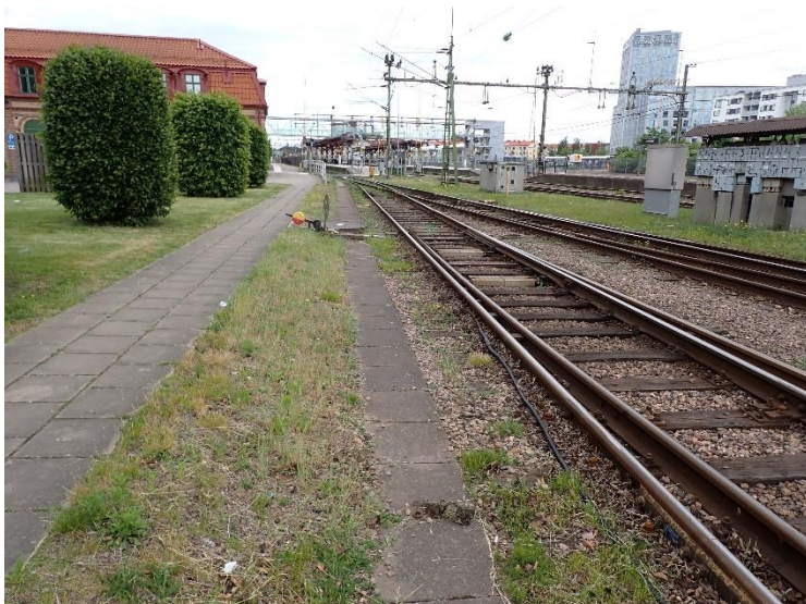
Figur 13. Kabelrännor i betong som kan innehålla förhöjda halter av PCB, metaller (krom och krom 6), PAH och oljeföreningar.
