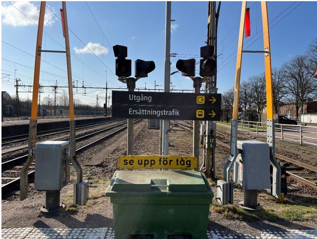
Figur B25. Bomanläggning vid plankorsningen som leder till plattformarna vid spår 1 till 4. Spår 1 till höger.
