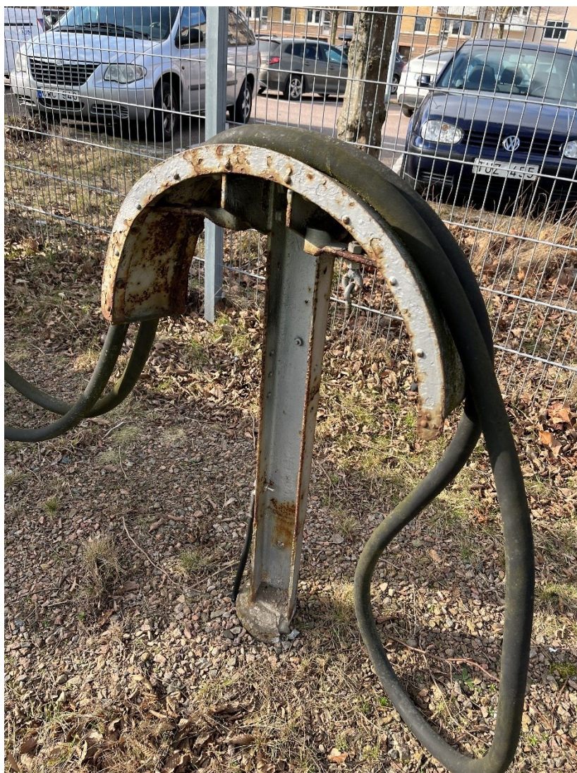
Figur B30. Nitad tågvärmepost.
