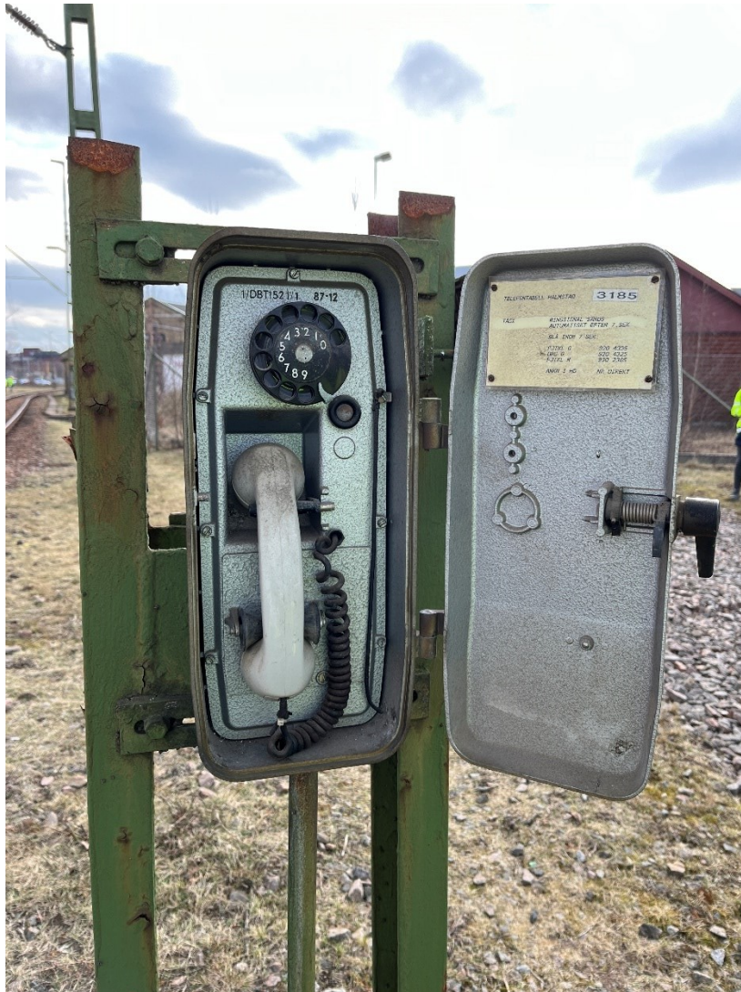
Figur B32. Bangårdstelefon på kapad kontaktledningsstolpe. Genom stolpen skymtar det östra av de tre rundlokstallen.
