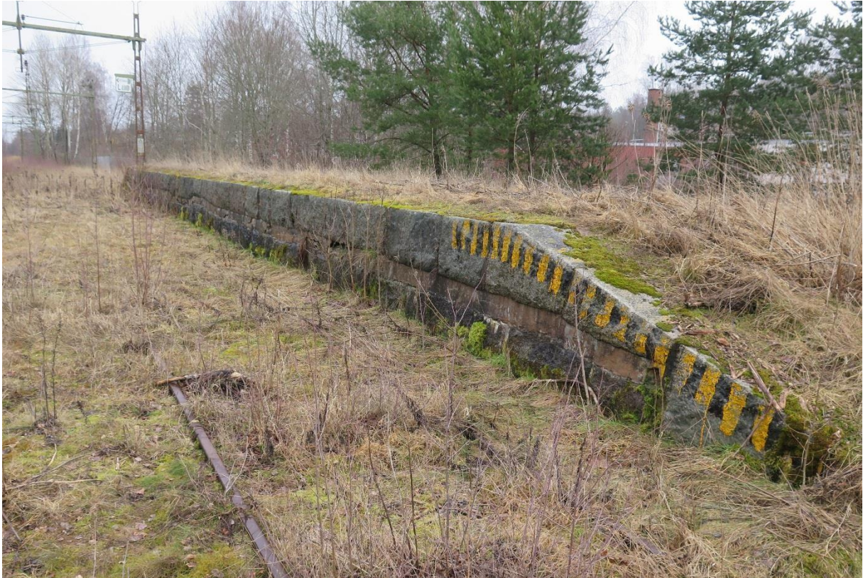
Lastkajen från sydväst. Spåret går i riktning Karlsborg. Godsmagasinet stod strax till höger om lastkajen utanför bild.
