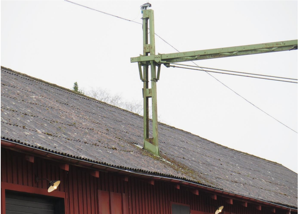
Foto från norr. Detaljbild på den ovanliga placeringen av kontaktledningsstolpen genom godsmagasinet tak.
