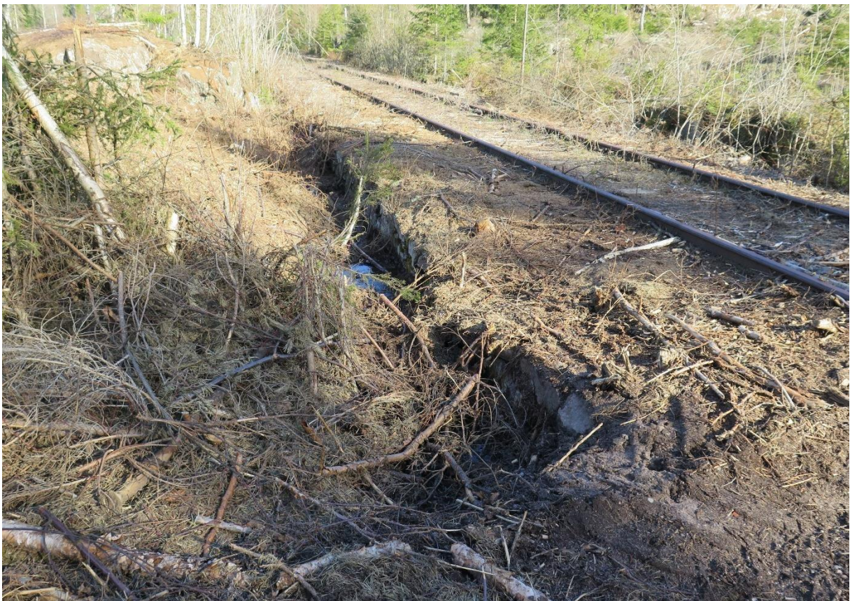
Här har man byggt en stensättning parallellt med järnvägen på ömse sidor. Här krävs extra försiktighet när rälsen avlägsnas. Denna är belägen strax öster om Marhultsby.
