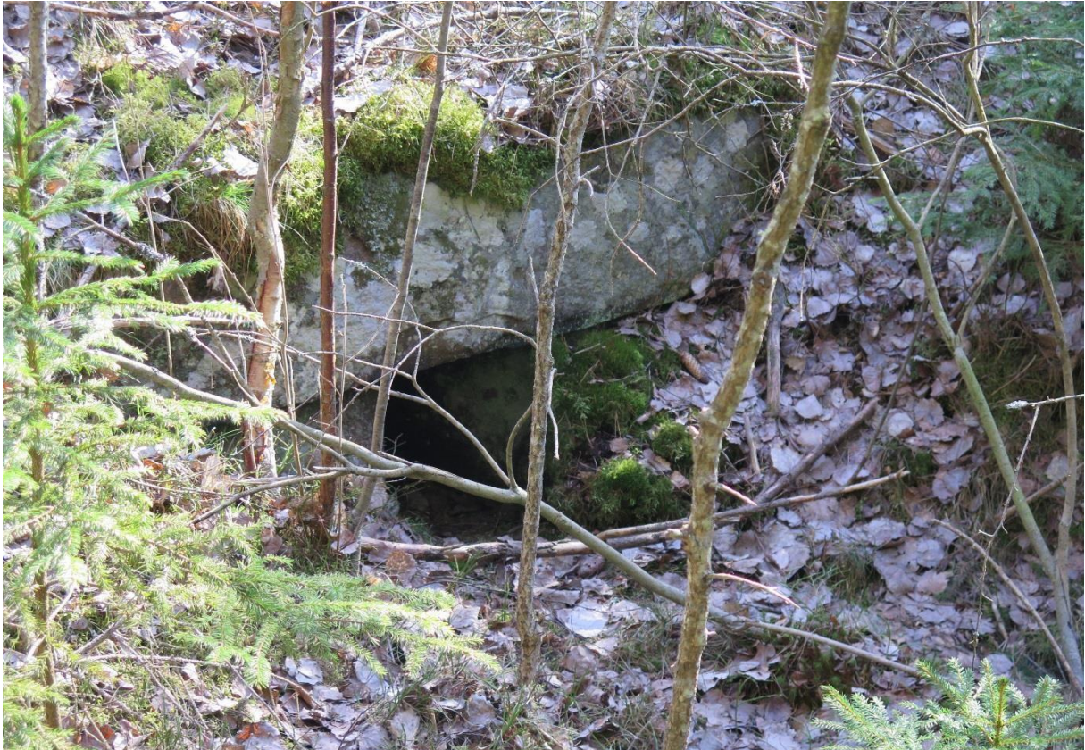
Mindre kulvert under järnvägen. I detta fall kan den var svår att se uppifrån banvallen.
