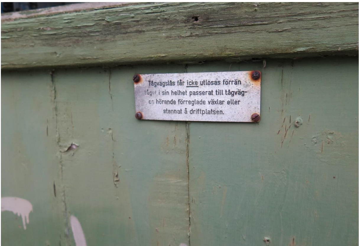
Syftet med detta budskap är det inte många som förstår idag. Skylten sitter på något som kan liknas vid ett mindre ställverk/apparatskåp som numera är länsat på sitt innehåll.
