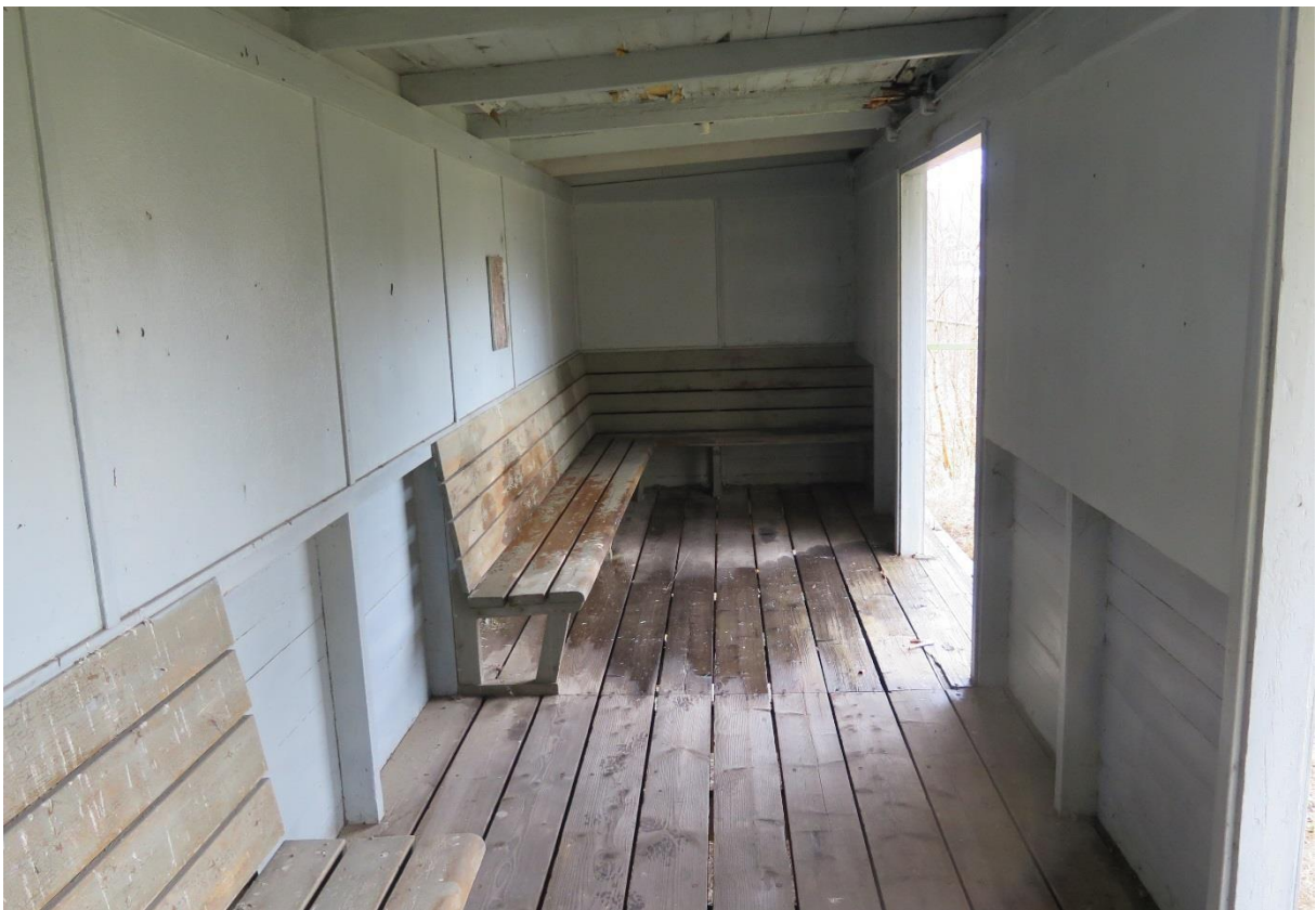
Här syns resultatet av det läckande taket.
