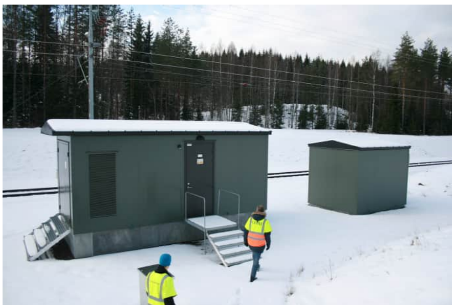
Figur 43 - Exempel på hur de teknikhus som placeras i naturmark ska se ut, modellen är densamma som använts i delsträckan Dunsjön-Jakobshyttan med planerad byggstart 2020. Huset har en avskalad design och dess gröna färg får det att smälta in väl i landskapet.
