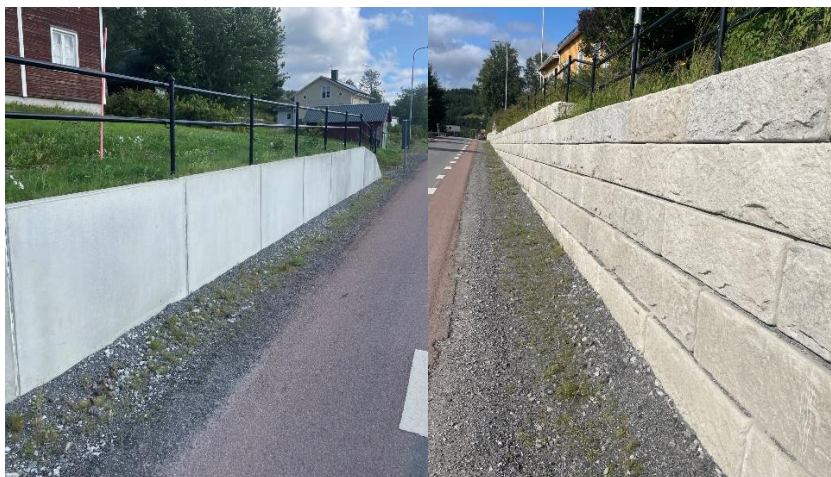
Figur 14 bilden till vänster visa ett L-stöd, bild till höger visar L-stöd beklädd med betongsten.
