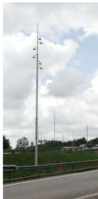
Referensobjekt Tingstadsmotet norr om Tingstadstunneln i Göteborg. Här har vägrummet rensats från ett bärlinesssystem med 55 st spännmaster och istället ersatts med 9st specialdesignade högmaster. Belysningsprojektör Rajna Popovic.
