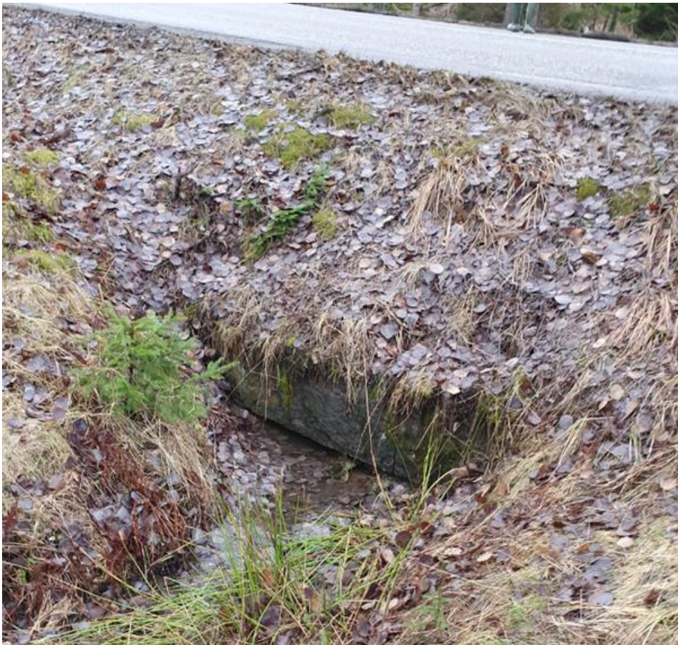
Figur 4.6.8:2 Befintlig trumma, igensatt.
