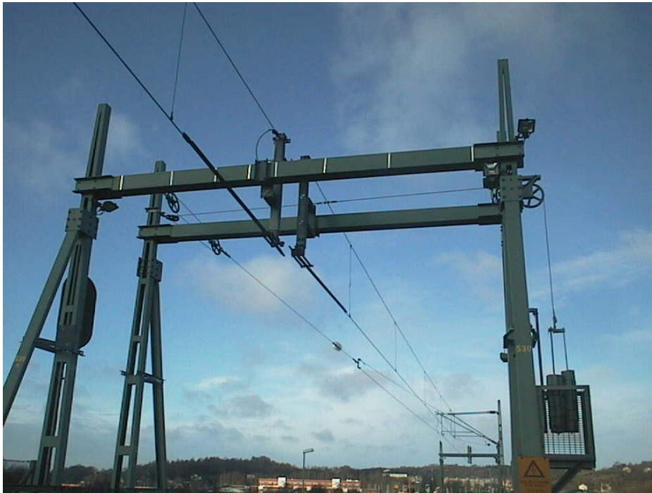
Brostolpe för kontaktledning på Marieholmsbron, svängbro
