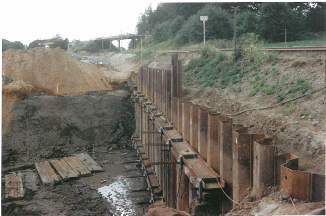
Banverket skall godkänna alla sponter intill järnvägsspår.
