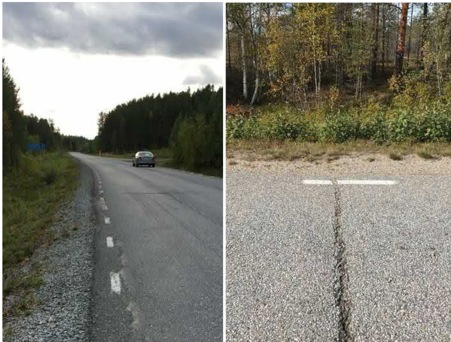
Figur 4:1. Befintlig vägkropp med sprickbildning och andra skador.
