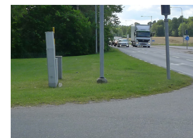
Bild 15. Signalskåp mitt i korsningen vid Kanton.
