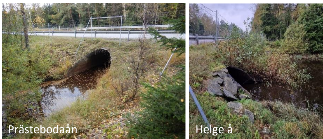
Figur 30. Till vänster: Bro över Prästebodaån. Till höger: Broar (två rörtrummor, varav en syns i bild) över Helge å.
