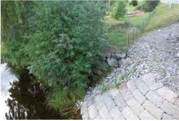
Fig. 37. Brofäste (22) och del av vägbank gömt i buskarna på Norrboåns NV strand. Foto mot NV.
