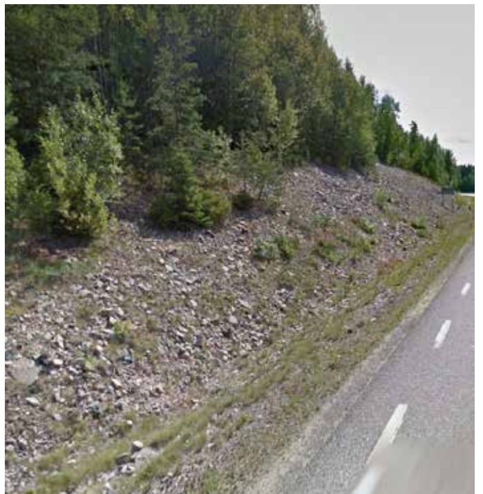
Ovan: Vid Gruffetåsen förekommer idag en brant skärning i åsen med öppen krosslänt. Grusslänten håller sakta på att växa igen av sly men hade fått en snabbare återställning med insådd av gräs.
