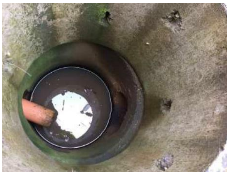
Figur 6. Brunn vid 11/300 med hål i brunnsvägg för intag av vatten som infiltrerat i dike, troligt inlopp från åkerdränering samt utlopp för vidare avledning.
