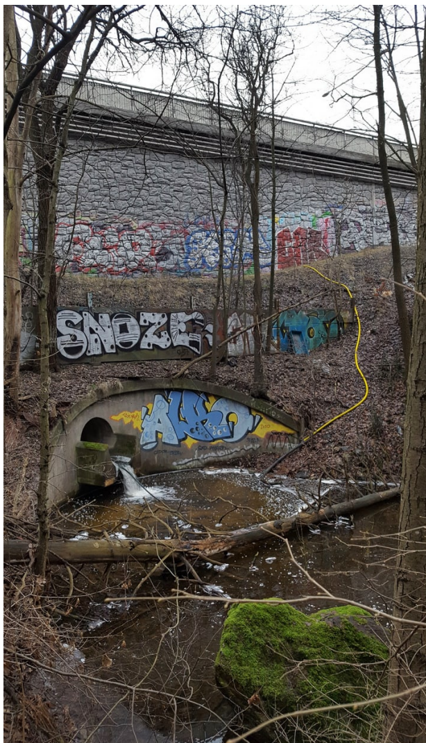
Figur 3.8 Vy mot E4/E20 vid Gömmarbackens utlopp på den västra sidan av vägen. Här syns befintlig stödmur och det fria fallet från trumman.
