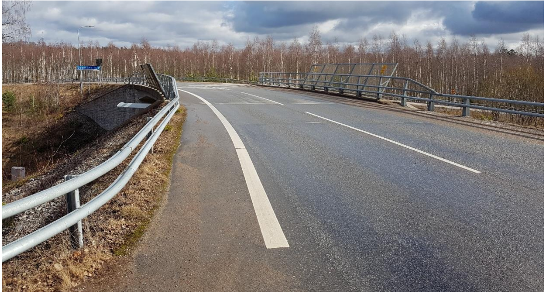
Figur 6. Vägbro över järnvägen i Mariestad där oskyddade trafikanter i dagsläget separeras med vägmålning. (Fotografi: COWI)
