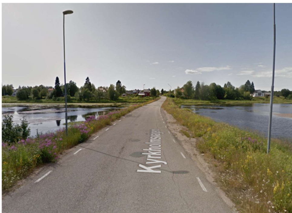
Figur 4. Befintlig vägbank. Asfalten är avhyvlat i ett tidigare skede. Vägbankens profilhöjd är efter avhyvling ca 15 cm lägre än tidigare.
