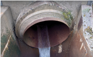
Figur 8.9:2 Stalp i Stavsättsbäcken som utgör ett vandringshinder.
