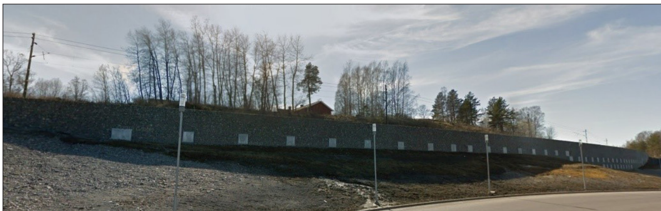
Figur 4.2:11 Befintlig spont och gabion behöver rivas och återuppbyggas med Alternativ Öst.
