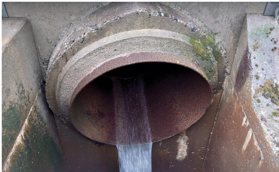
Figur 3.5:11 Stalp i Stavsättsbäcken som utgör ett vandringshinder
