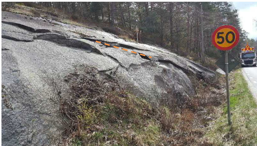
Figur 8 Bergskärning 4 med tydliga glidplan ut mot befintlig väg 1937, se streckad linje i orange.
