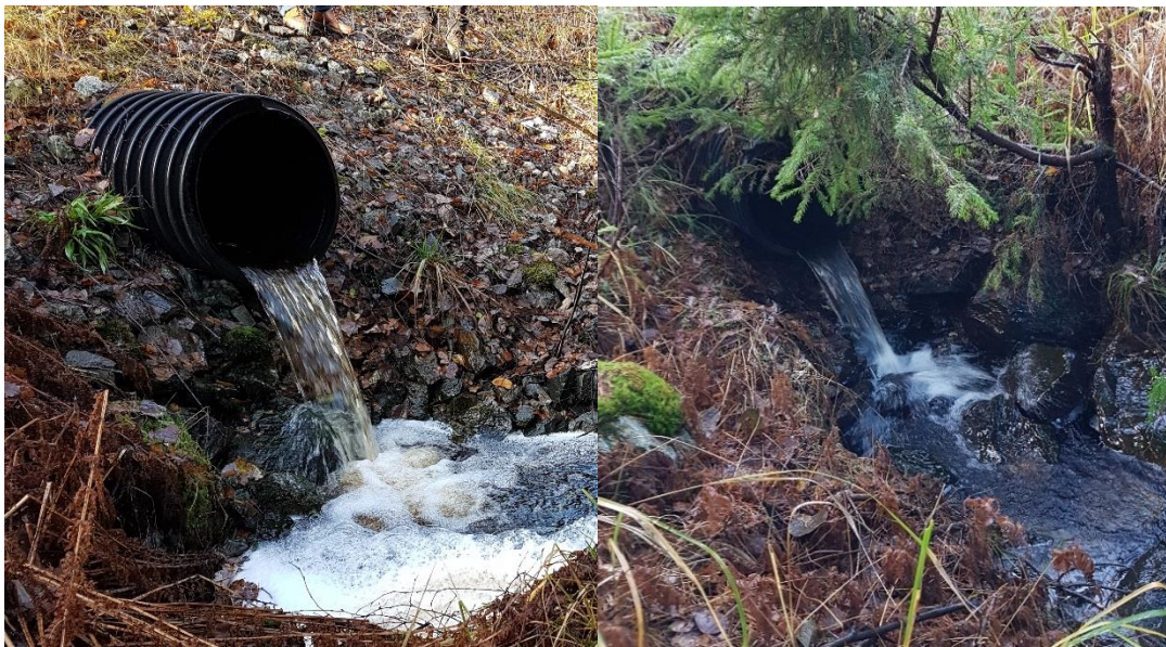
Figur 21. Trummor som kan antas utgöra vandringshinder för grod- och kräldjur. Bild till vänster: Trumma sydväst om Knipan/norr om Haget, km 10/220. Fotot taget på östra sidan av väg 2183 i västlig riktning. Bild till höger: Vattendrag från Stenbrotjärnet, km 13/280. Fotot taget på östra sidan av väg 2183 i västlig riktning.
