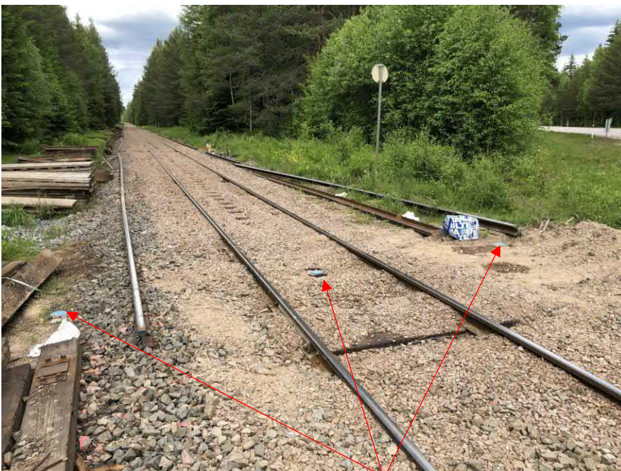
Foto 17. Grundvattenrör syns mitt i bild (Blåa lock). Bild över växtlighet. Provtagningsomgång 2.
