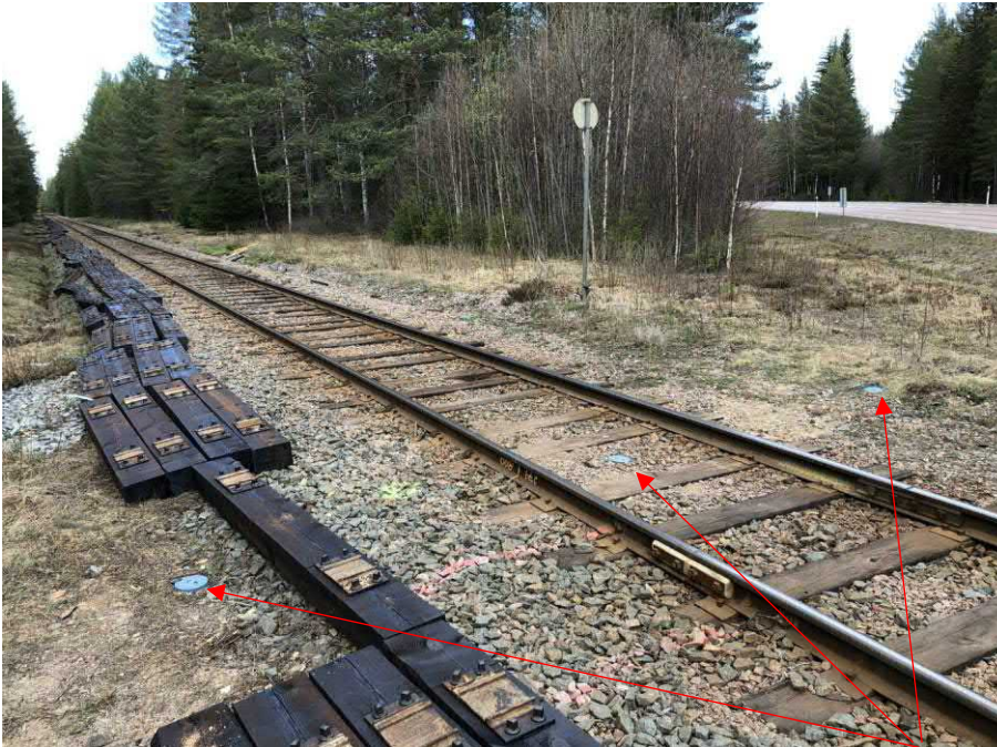
Foto 16. Bild över växtlighet. Slipers uppradade inför byte av slipers. Blåa lock i bild är grundvattenrör. Provtagningsomgång 1.
