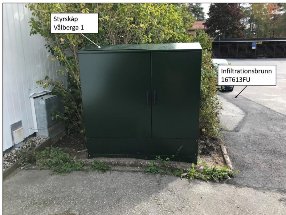
Figur 4. Infiltrationsanläggning Vålberga 1 med styrschåp och infiltrationsbrunn.
