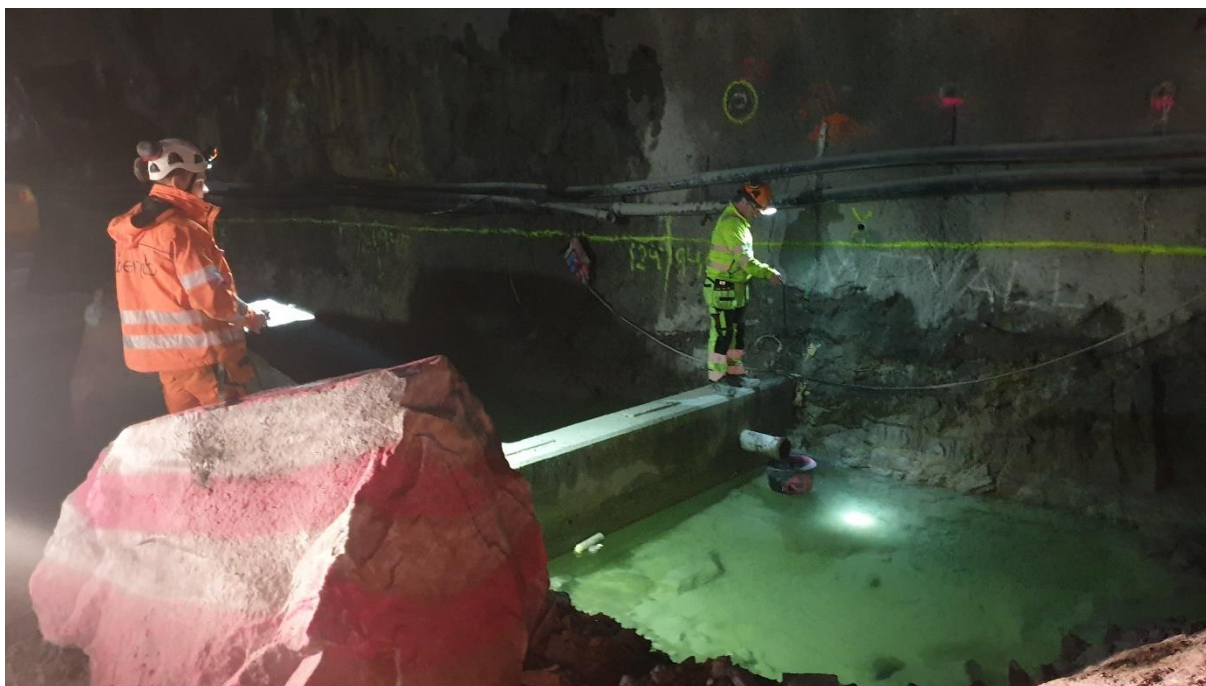
Figur 5. Mätning av inläckage på tunnelsträcka.
