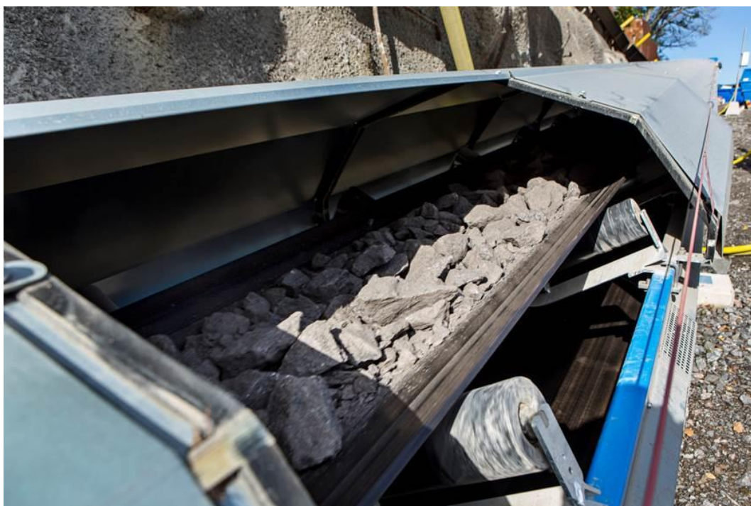
Figur 2. Inbyggnad av transportband vid Sättra varv.
