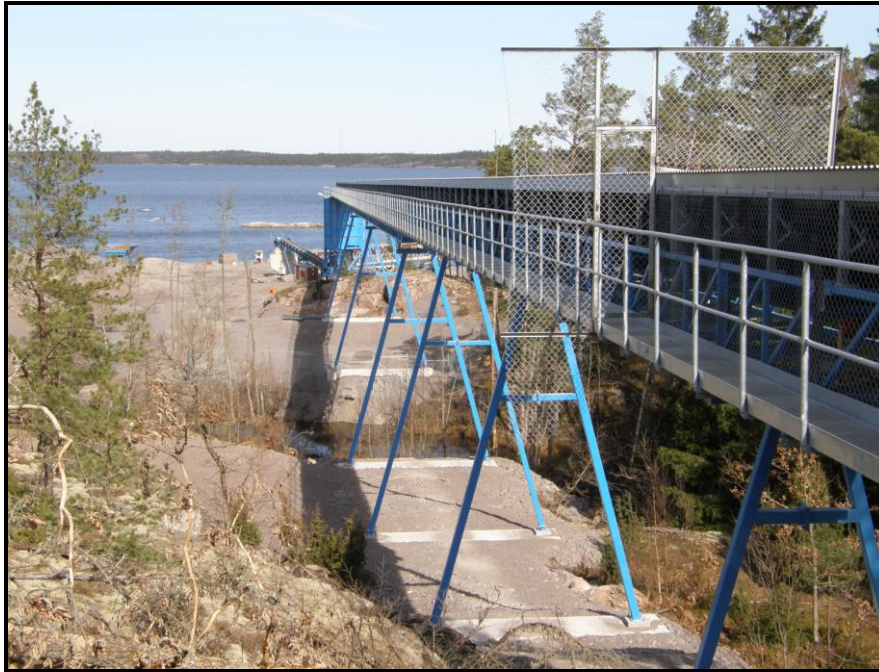
Foto 5.3 Exempel på bandtransportör på pelare (Foto: Kjell Windelhed, VV)
