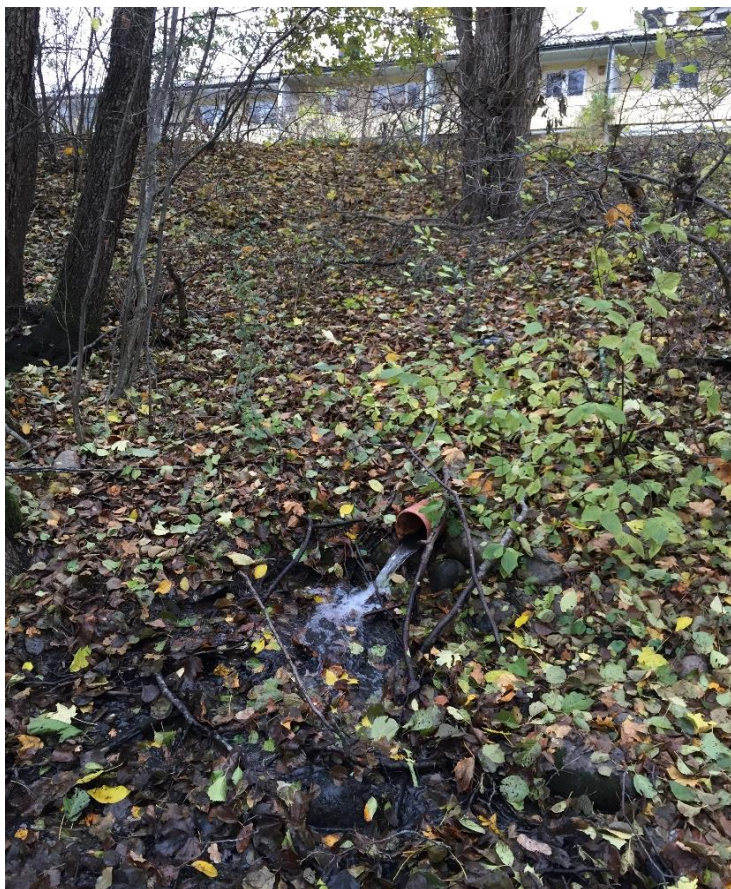
Figur 21: Befintligt utlopp från dagvattenssystemet ut i Sätträån.
