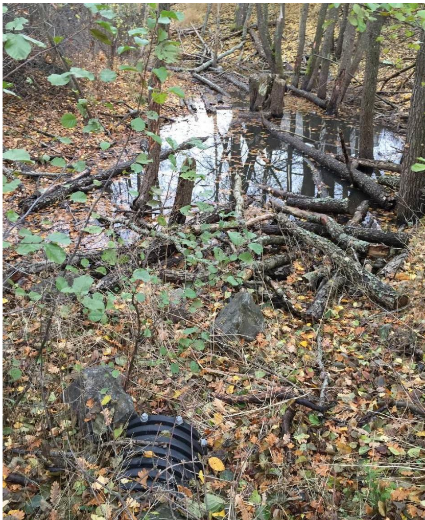
Figur 25: Trumma i gc-väg. Foto taget med vy uppströms och visar på att vatten ej rinner genom trumman utan ansamlas och infiltrerar.
