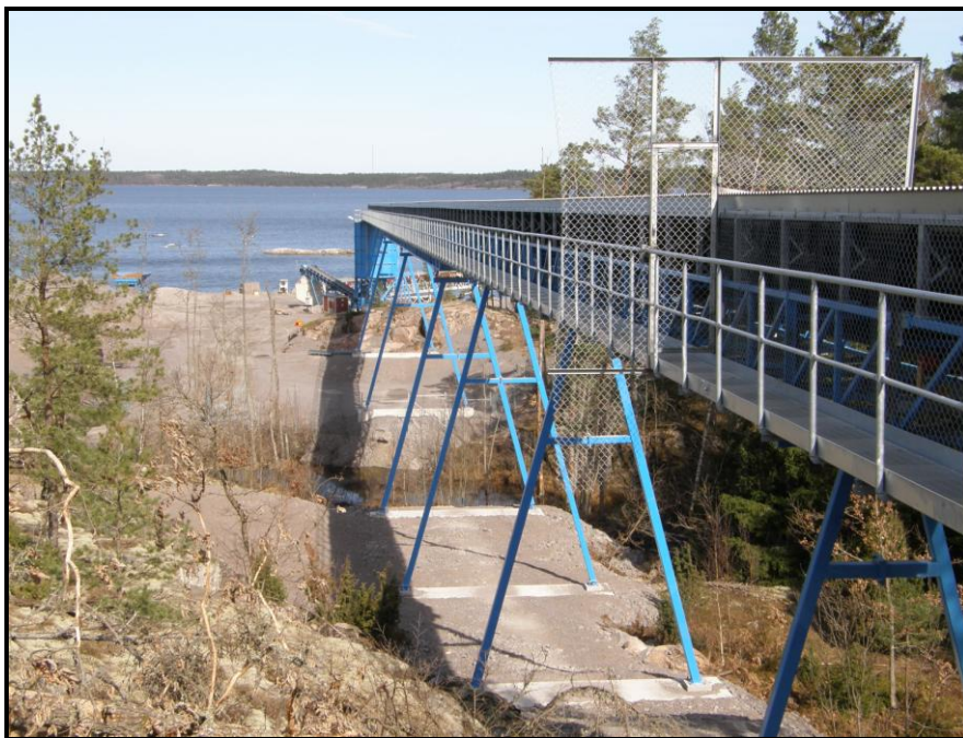
Foto 5.3 Exempel på bandtransportör på pelare (Foto: Kjell Windelhed, Trafikverket)
