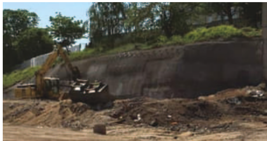
Figur 17. Jordspikning. Exempel från breddning av bangård i Södertälje. NRC Group. Bild: Trafikverket.
