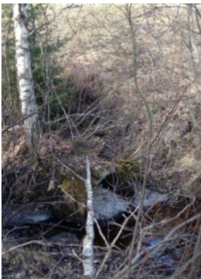
Bild 17; visar exempel på vägtrumma som behöver bytas, här på den östra sidan av E12.
