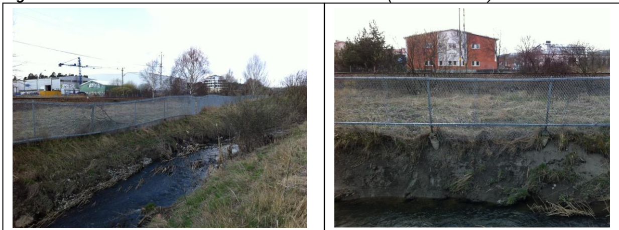
Figur 11: Foto som visar erosion vid Bällstaåns vattenfåra (ca KM 12+400)
