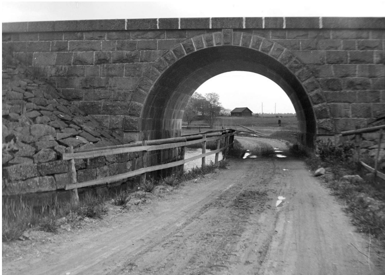
Figur 26. Järnvägsbro från 1866 vid Knivsta sockencentrum. Notera att ån och vägen delade på utrymmet under bron. I broöppningen syns Kvarngården. Foto: Schagerström, August Fredrik, 1927, Upplandsmuseum.
